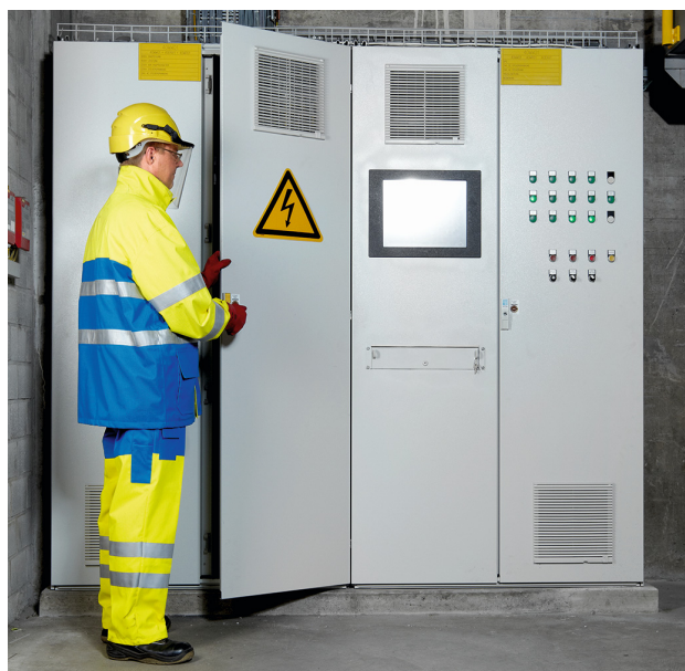
3 EPI obligatoires pour ouvrir la porte d'une armoire de commande.
