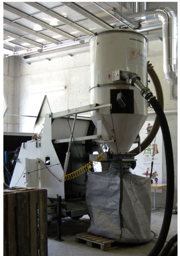
Staubsauger für Grossanlagen. Bild: Patrick Abbühl.
