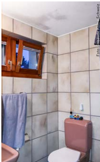
Bilder, wie man sie oft antrifft: Ältere Badezimmer mit Feuchtigkeits- oder Schimmelschäden an Decke und Wänden.
